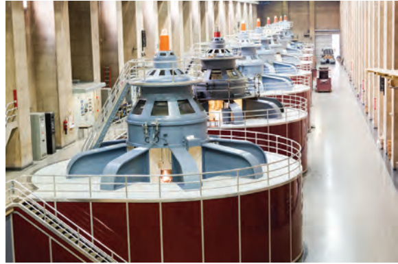
Şekil 7.3 Hidroelektrik güç üretim santrali alternatif akım üreteç türbinleri
